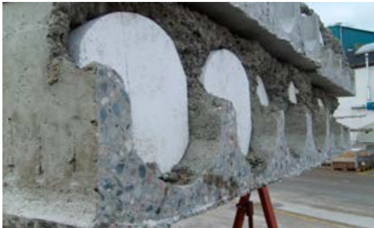
Foto 1: Udsparring i overside/grøft ved elementende
